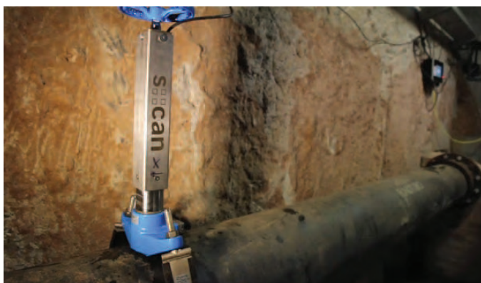
i::scan direkt in der Druckleitung installiert.
