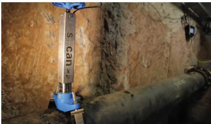
s::can direkt in der Druckleitung installiert.
